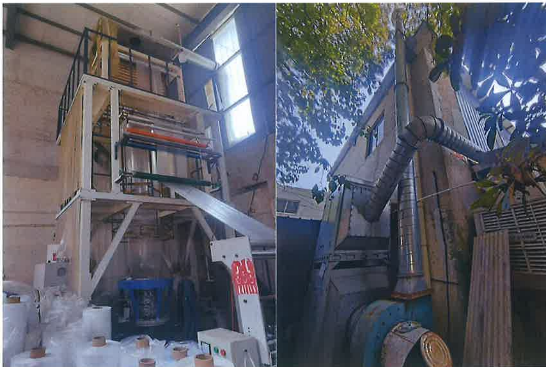
图 3-1 吹膜废气收集与处理设施照片
