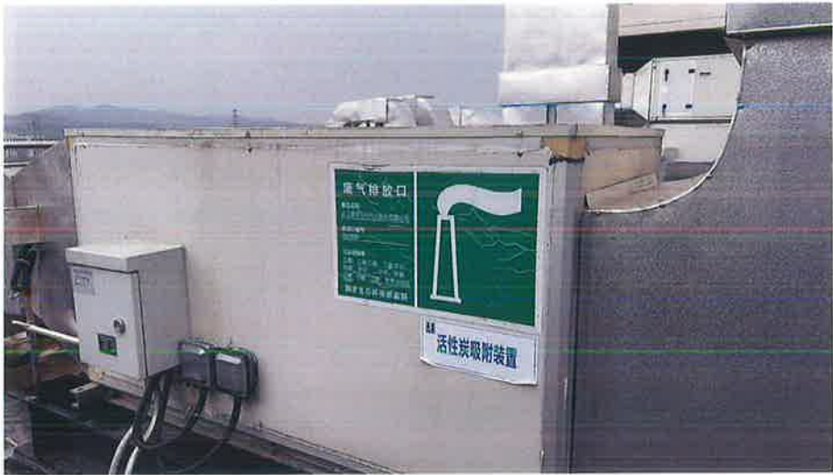
图 4-2 通风橱废气处理设施现场图
