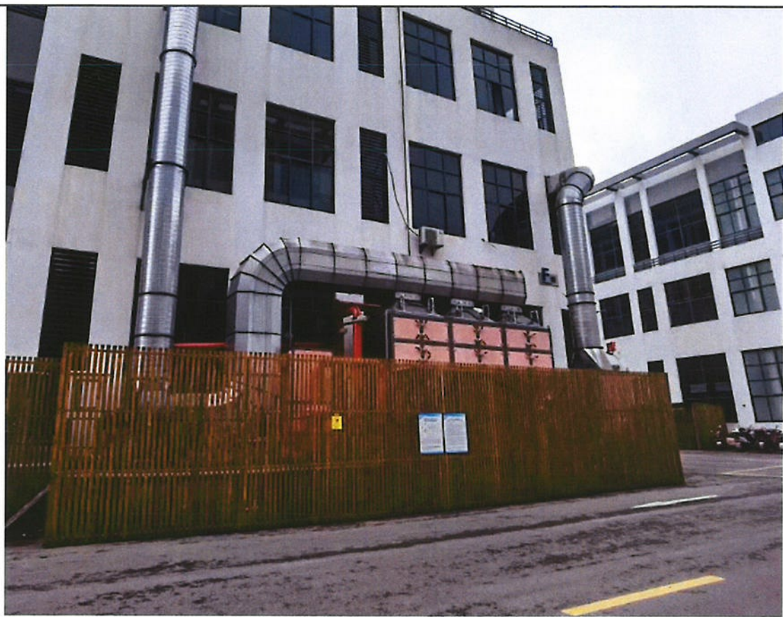
水喷淋+干式过滤+活性炭吸附装置
