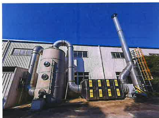
“水喷淋+除湿+两级活性炭吸附”装置
