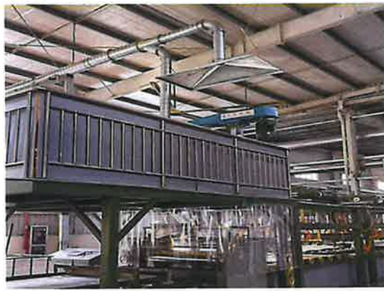
调胶设备环保收集设施照片
