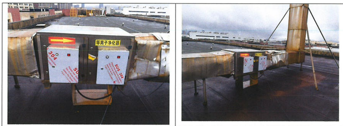
图 4.1.2-2 烧结废气处理设备图
