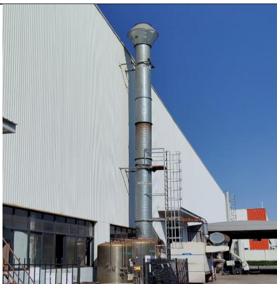
切割烟尘、焊接烟气废气处理设施
