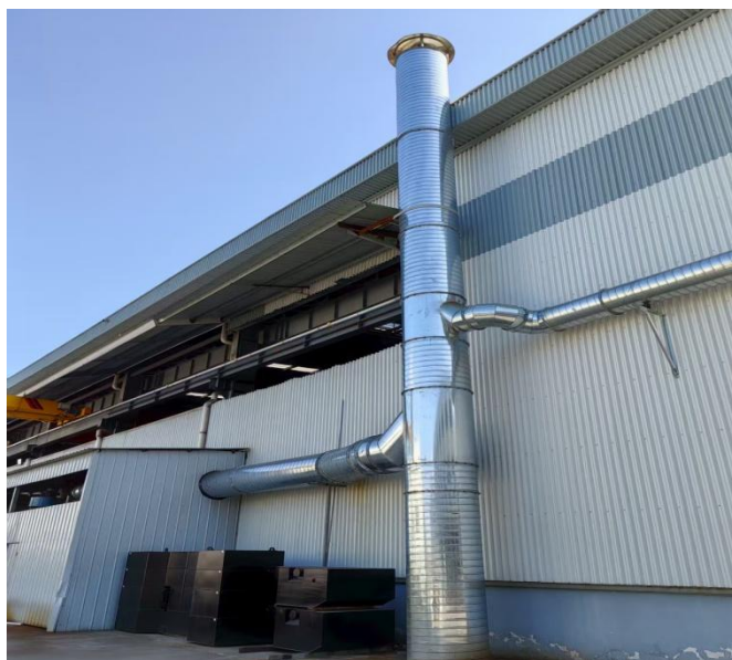
抛丸废气处理设施
