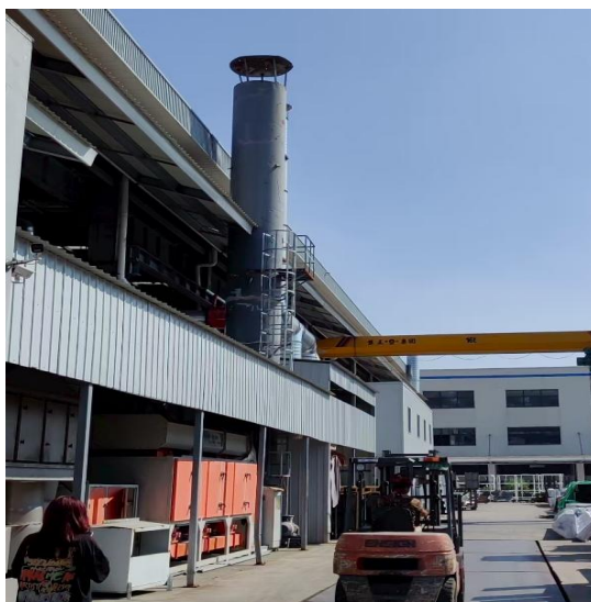
过滤棉+活性炭吸附+脱附+在线 RCO 废气处理设施
