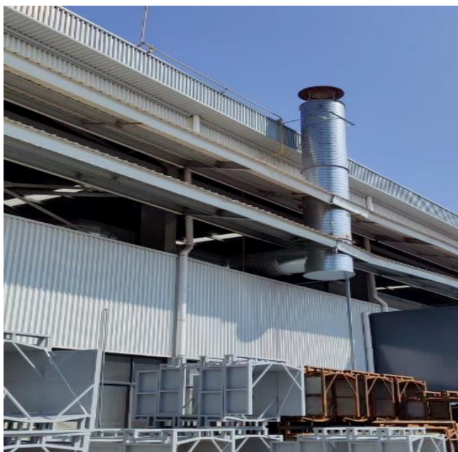
打磨废气处理设施
