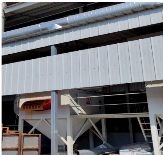
喷塑废气处理设施
