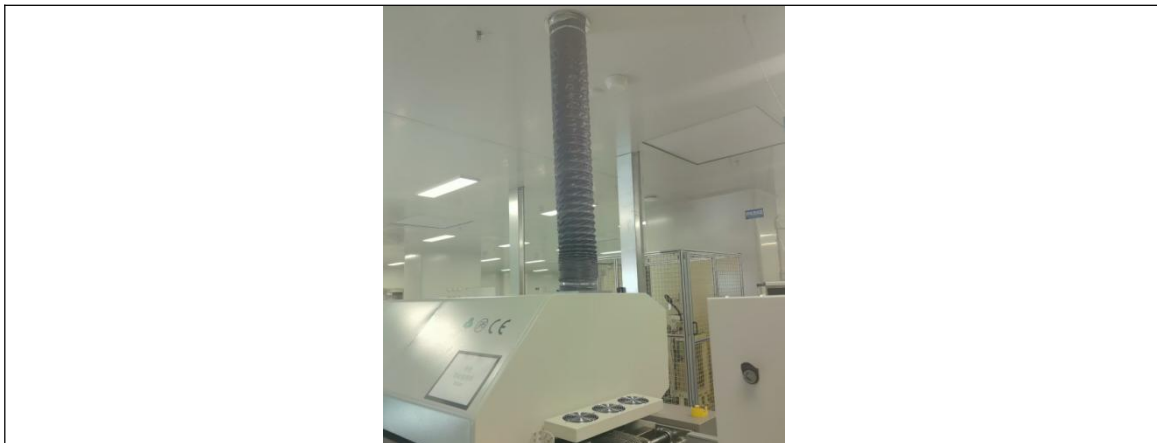
图 3.1-2 设备自带活性炭过滤棉装置
