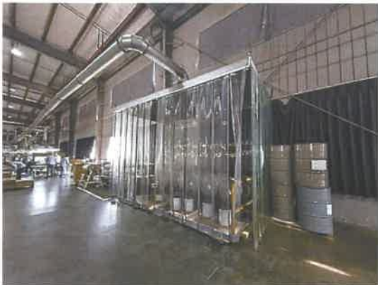
涂料分装废气收集措施
