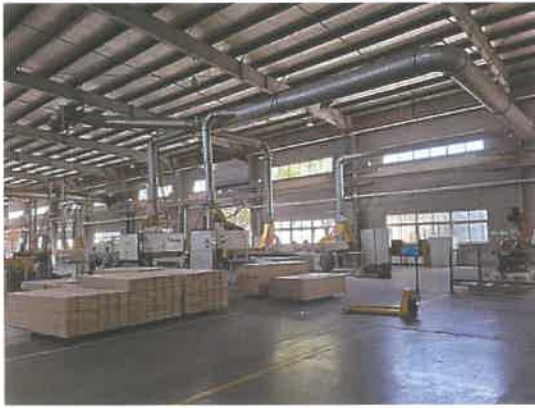
木工粉尘收集措施
