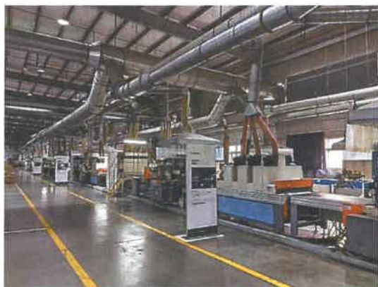
涂料固化废气、涂料烘干废收集措施
