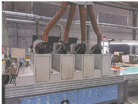
涂料固化废气收集措施
