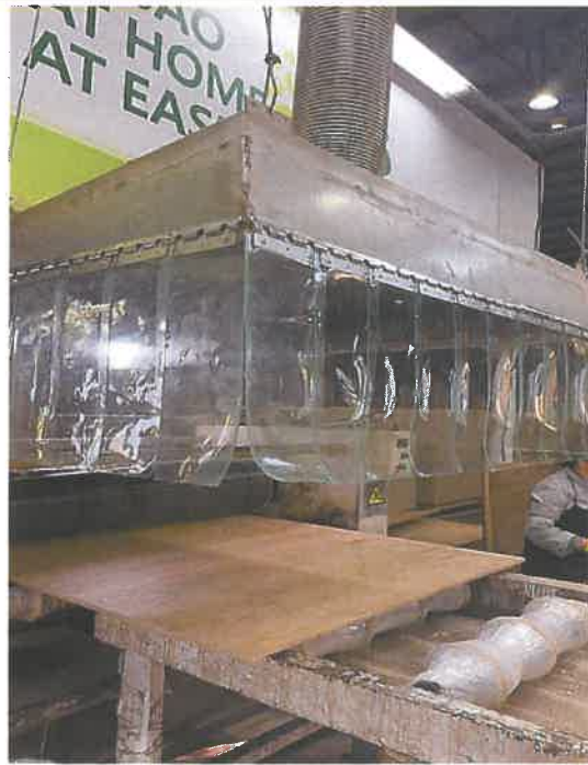
脲醛树脂胶涂胶废气收集措施
