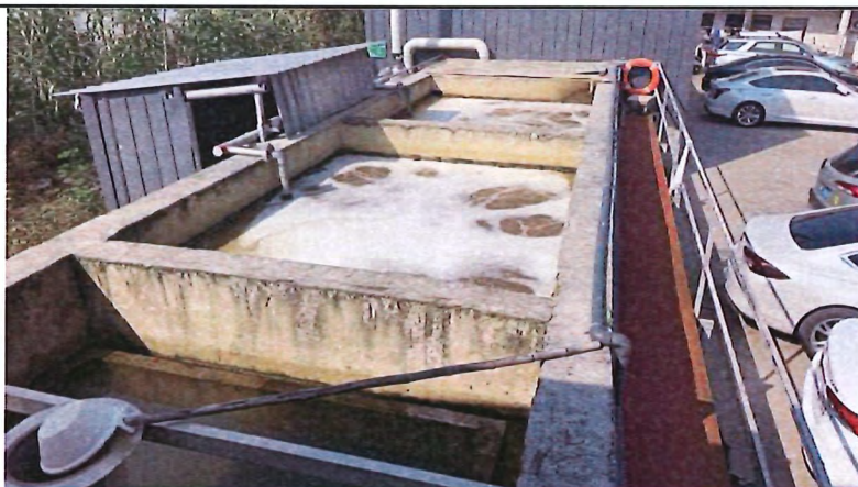
污水站生化段
