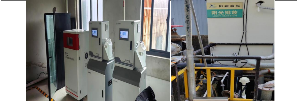
在线监测设施及阳光排放口
