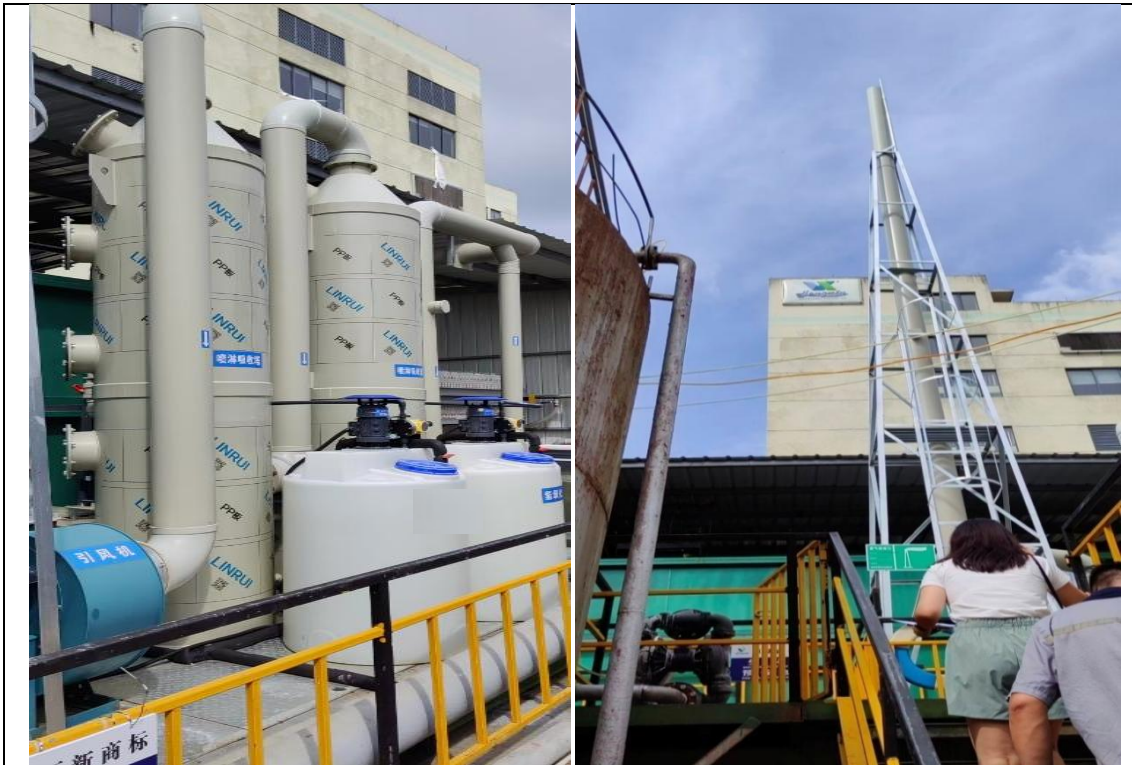
水喷淋装置及排气筒
