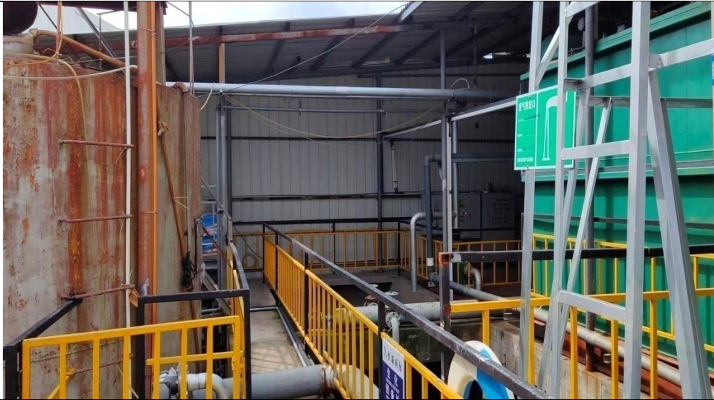
污水站生化段
