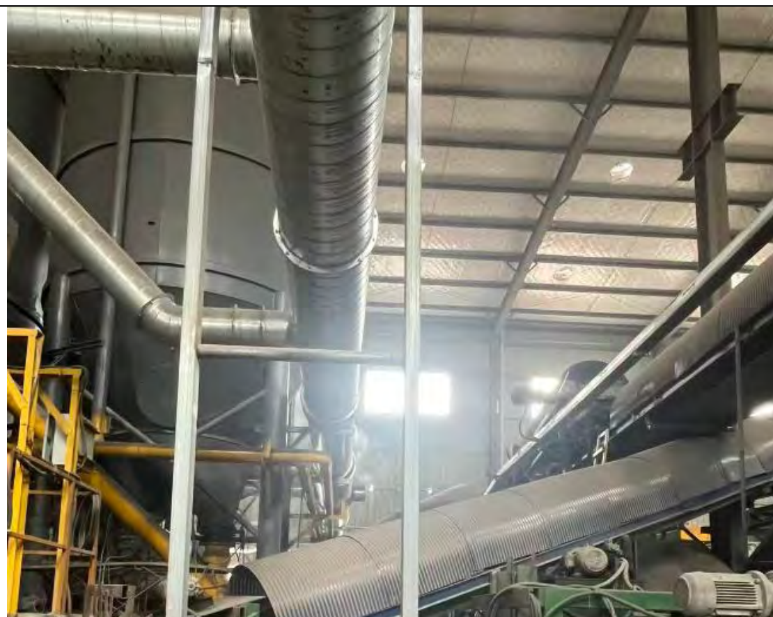
集气罩+收集管道-废气收集方式
