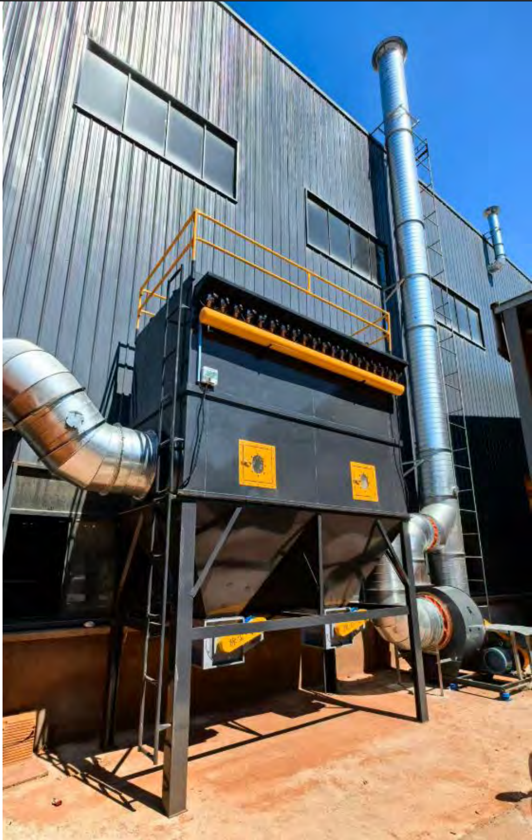
布袋除尘装置-投料搅拌粉尘
