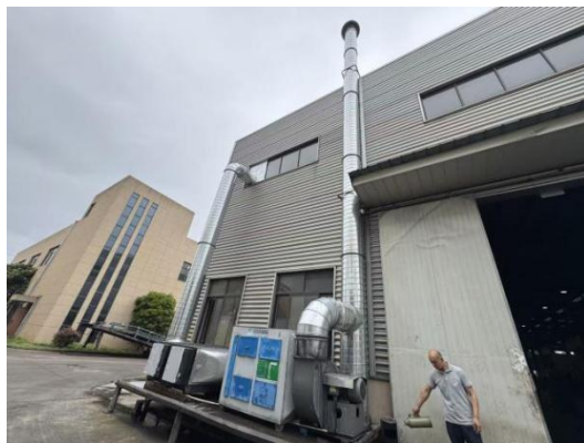
上油废气处理装置
