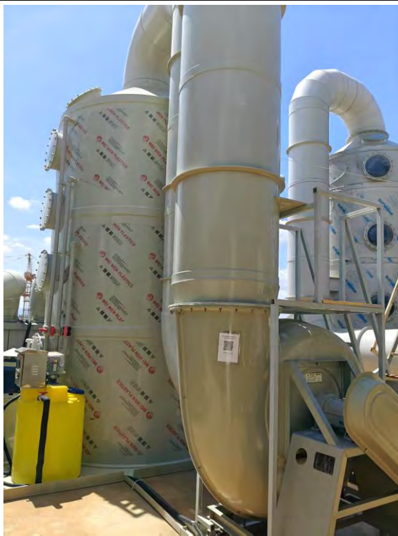
DA014/三层喷淋塔
