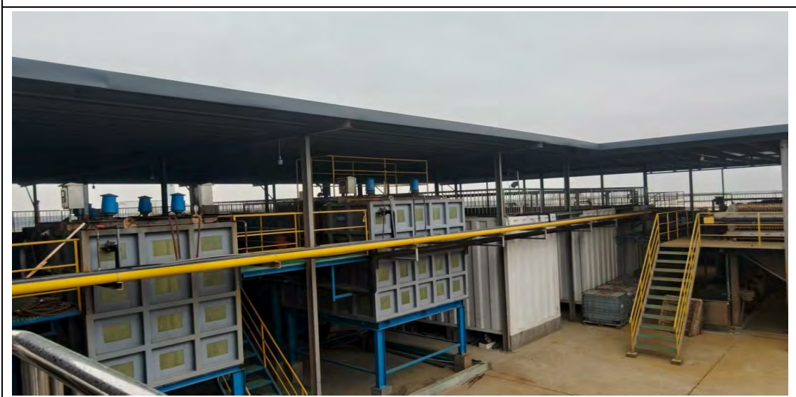
楼顶污水站总览
