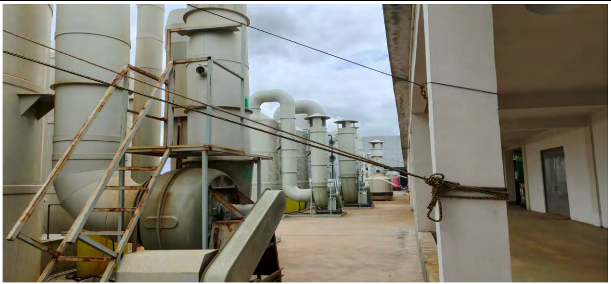
酸雾废气治理设施（总览）
