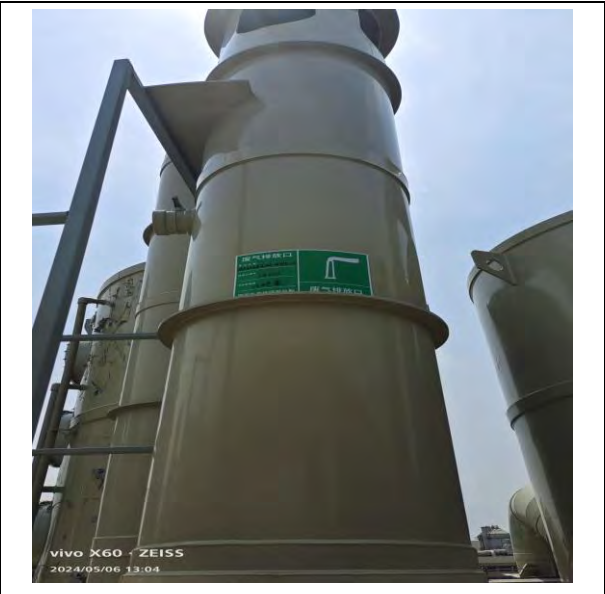
DA002/三层喷淋塔
