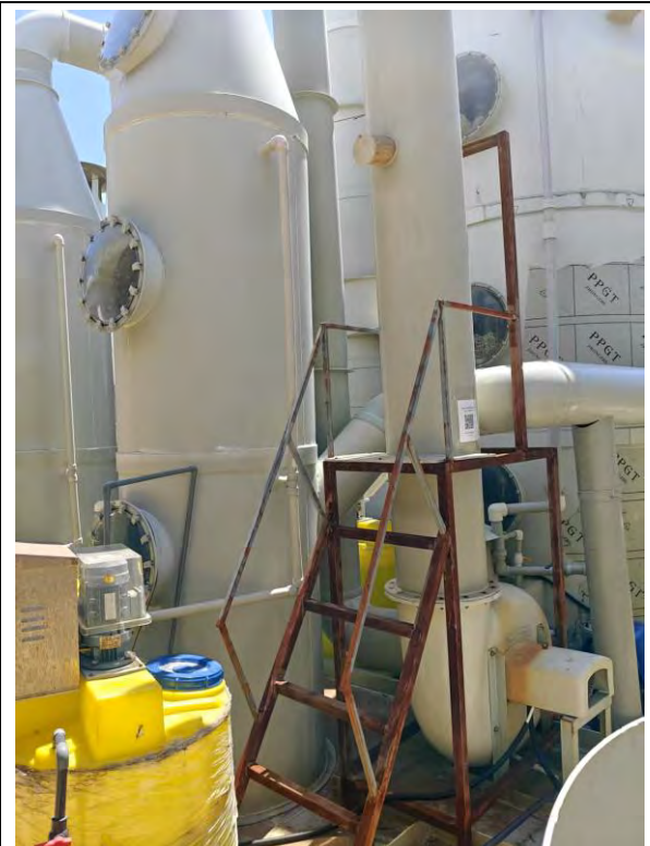
DA013/三层喷淋塔
