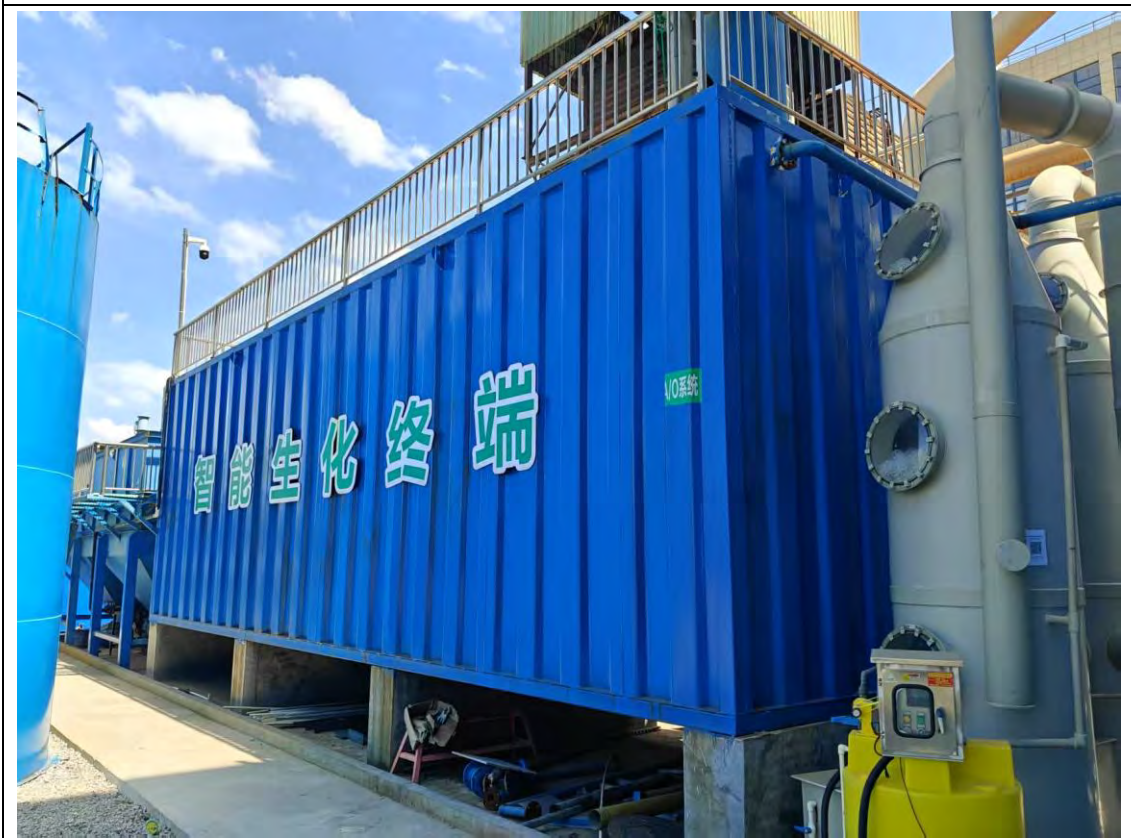
一楼污水站（生化）
