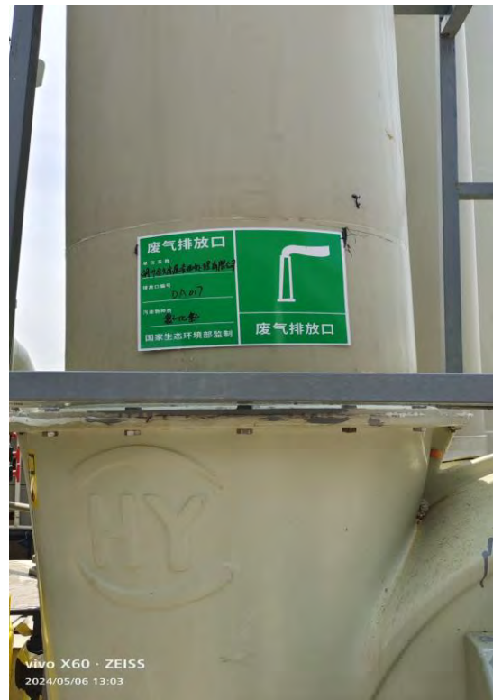
DA017/三层喷淋塔
