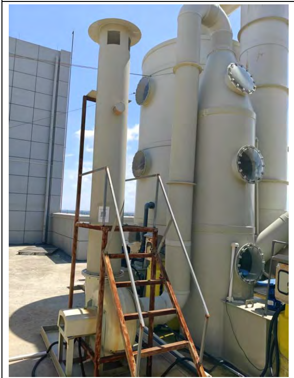
DA003/三层喷淋塔
