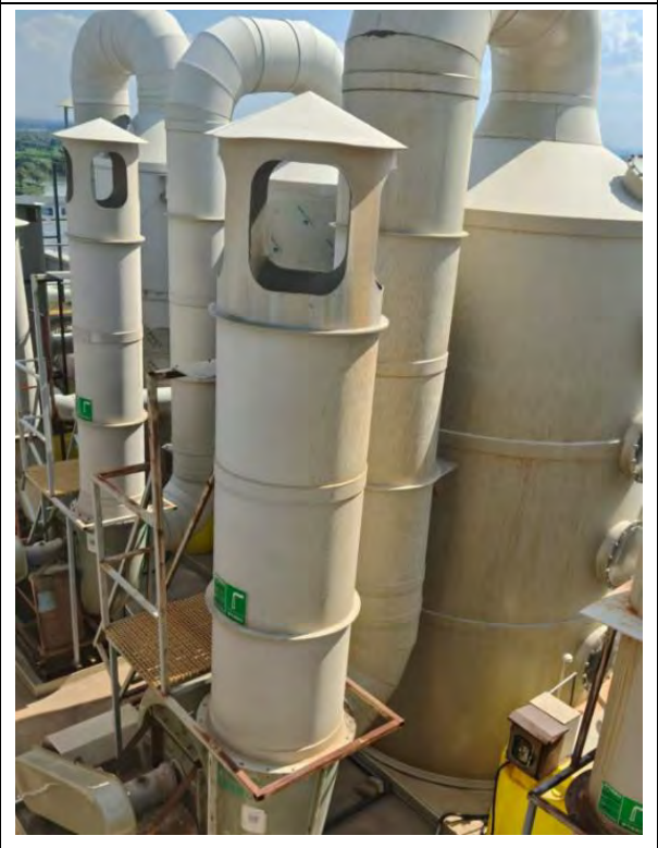
DA004/三层喷淋塔
