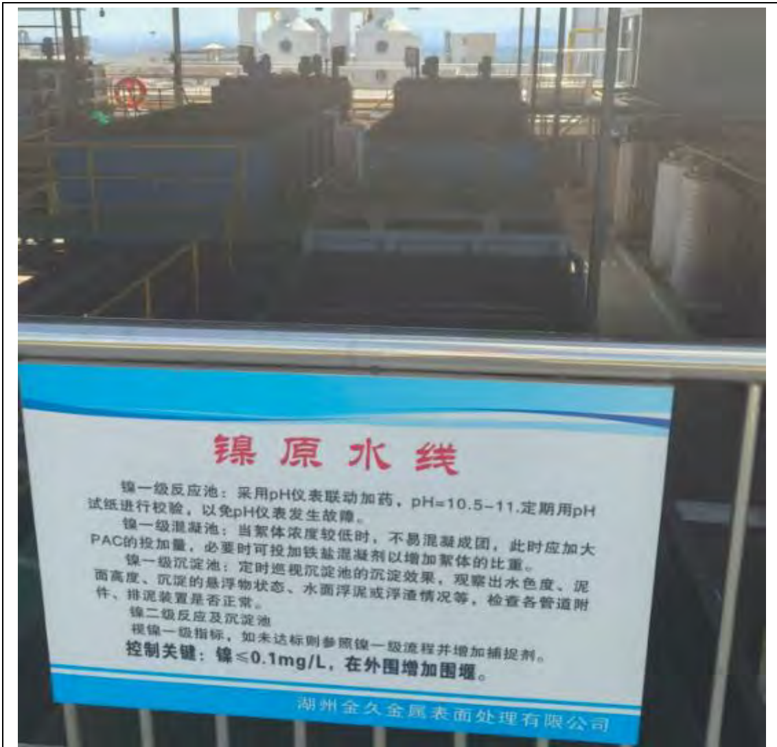
污水站（含镍水预处理）
