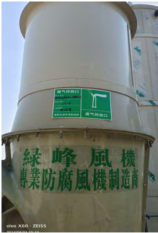
DA016/三层喷淋塔
