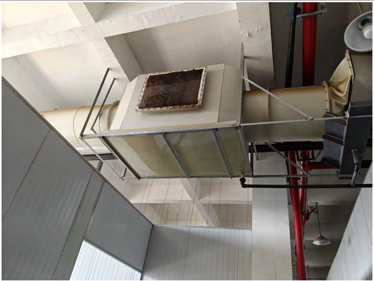
铬酸雾凝聚回收装置
