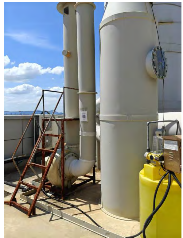
DA015/三层喷淋塔
