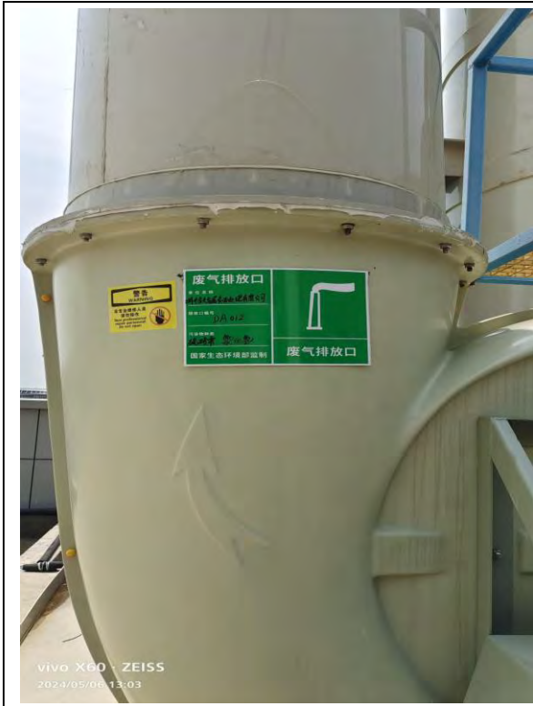
DA012/三层喷淋塔
