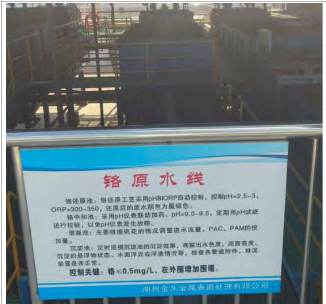
污水站（含铬水预处理）
