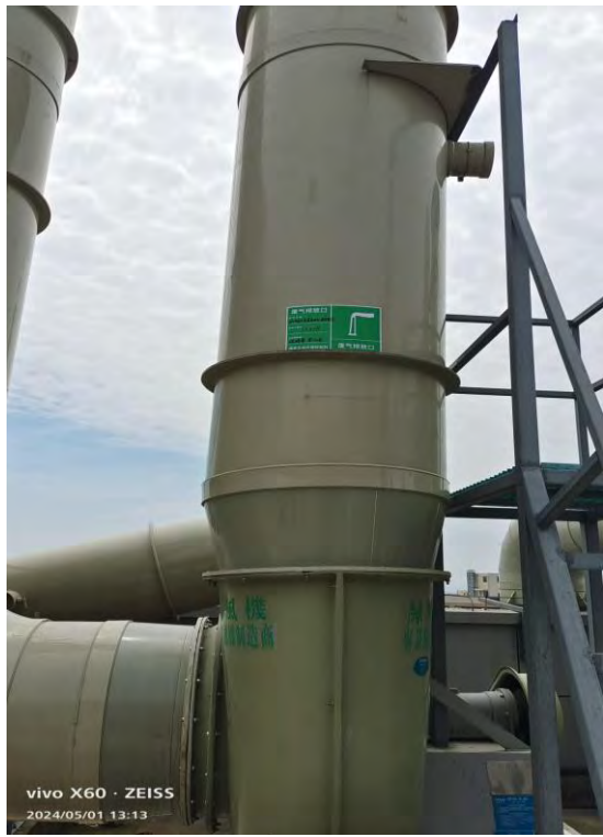
DA008/三层喷淋塔
