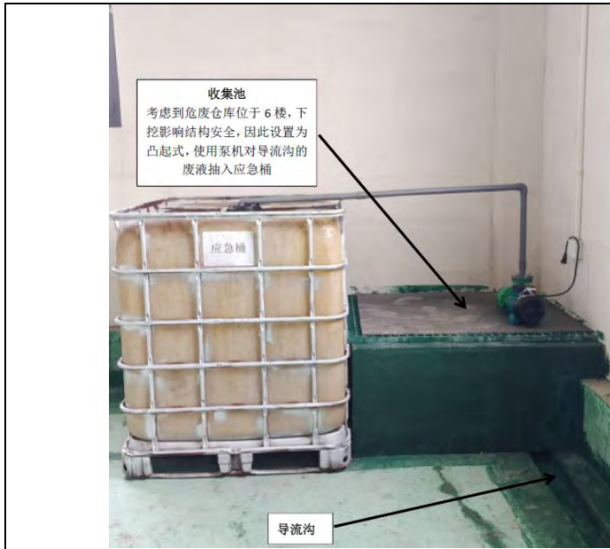
危废仓库应急设施
