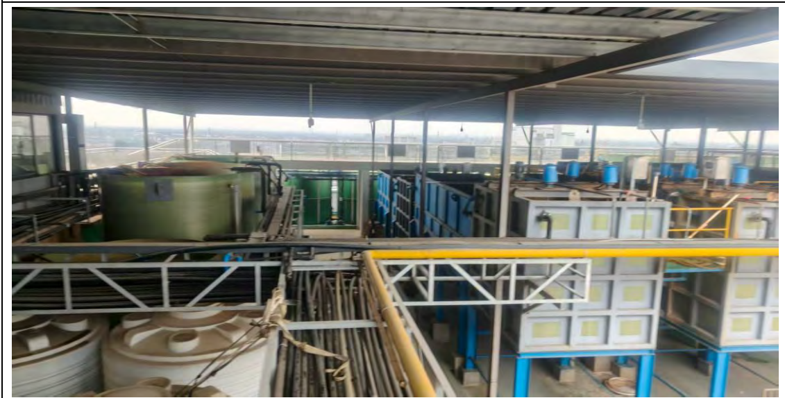
楼顶污水站总览
