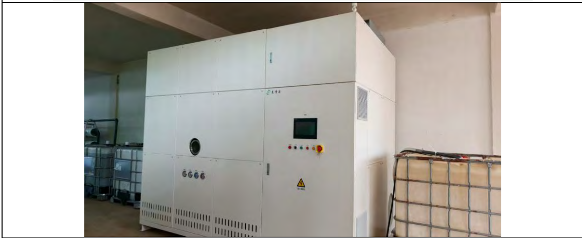
图 4.1-3 低温蒸发器运行工艺图及实际设备图
