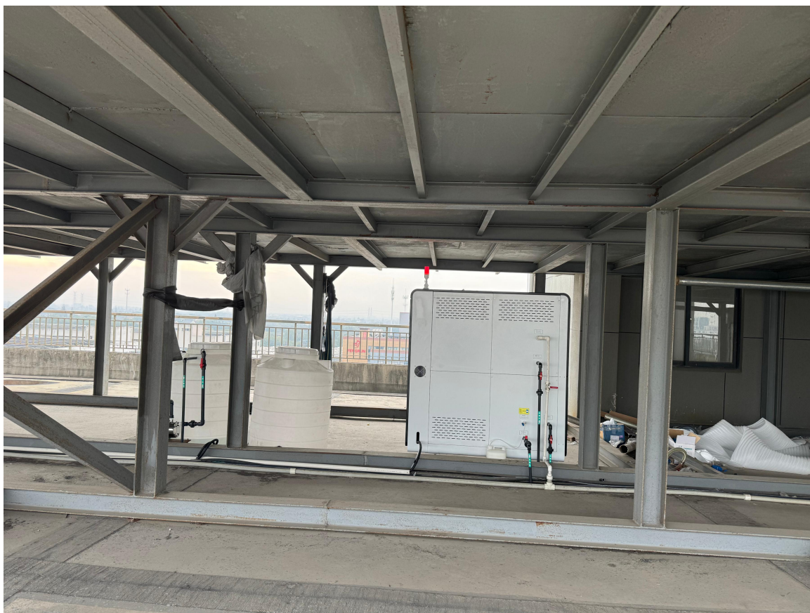
图 4-2 低温蒸发浓缩器现场图
