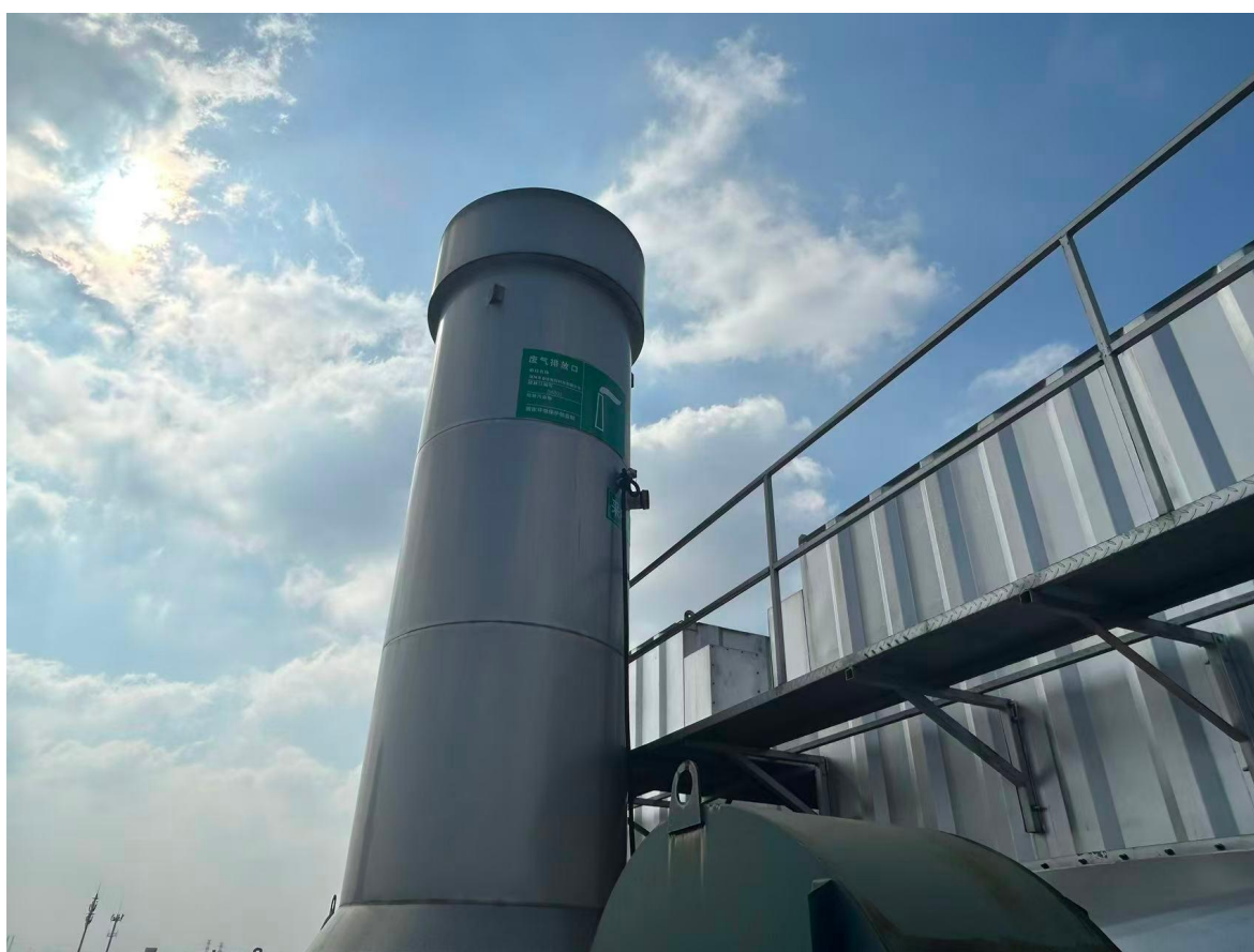
图 4-1 定型废气处理设施现场图
