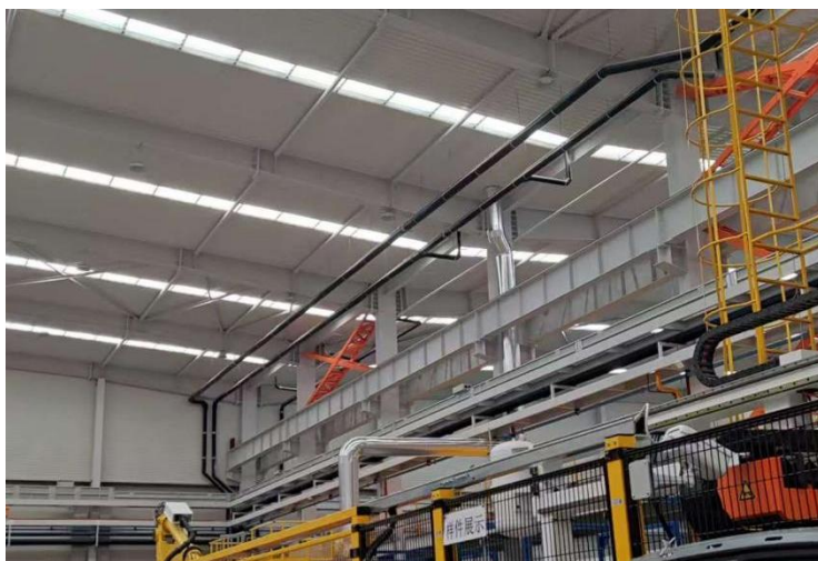
图 3-3 天然气燃烧废气排气筒
