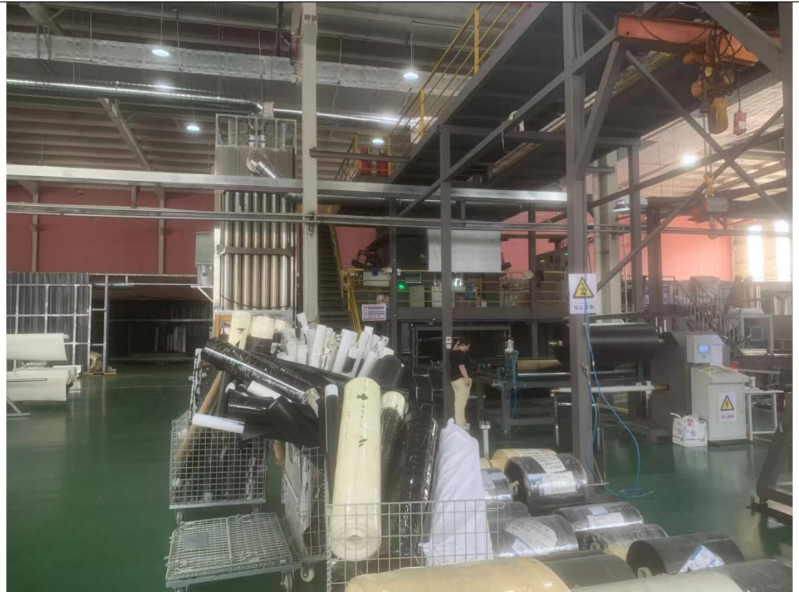
图4 发泡废气处理设备图（湿式高压静电装置）
