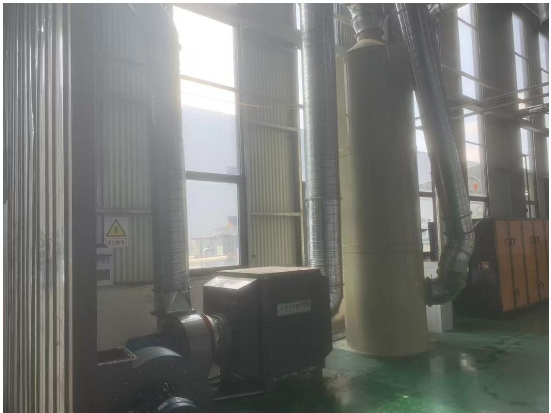
图5 发泡废气处理设备图（水喷淋装置）
