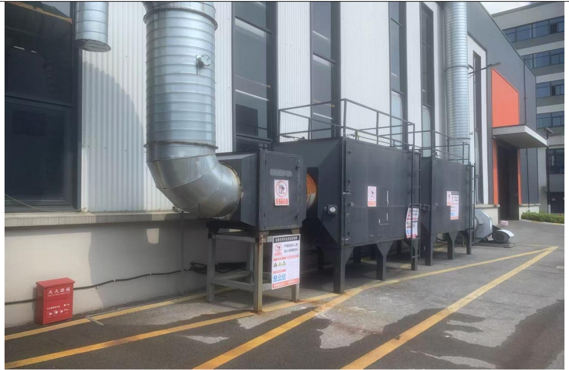
图6 发泡废气处理设备图（活性炭吸附装置）
