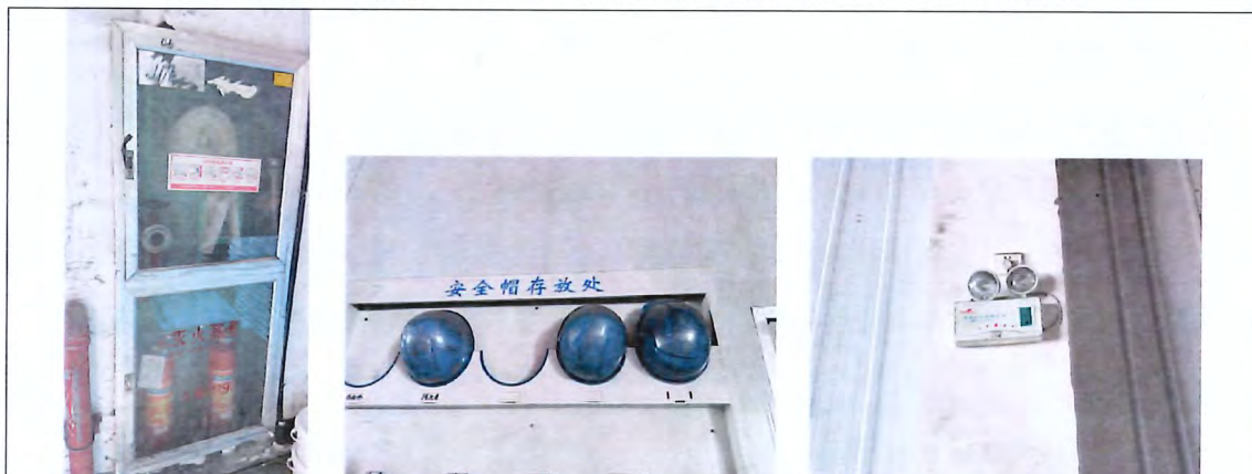
应急设施（消防栓、灭火器、安全帽、应急灯）
