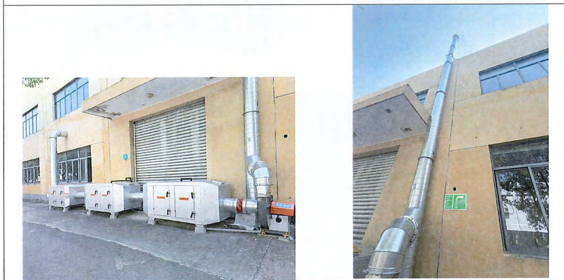
“干式过滤器+两级活性炭装置”及排气筒
