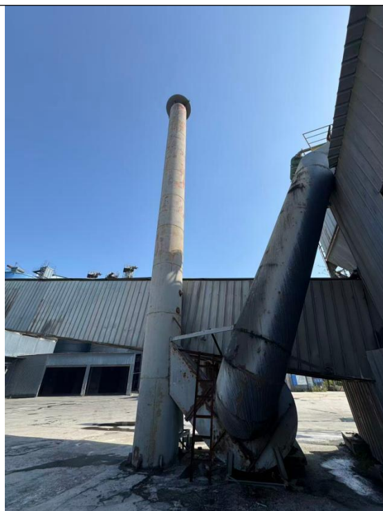
南侧吊机废气处理设施 TA016
