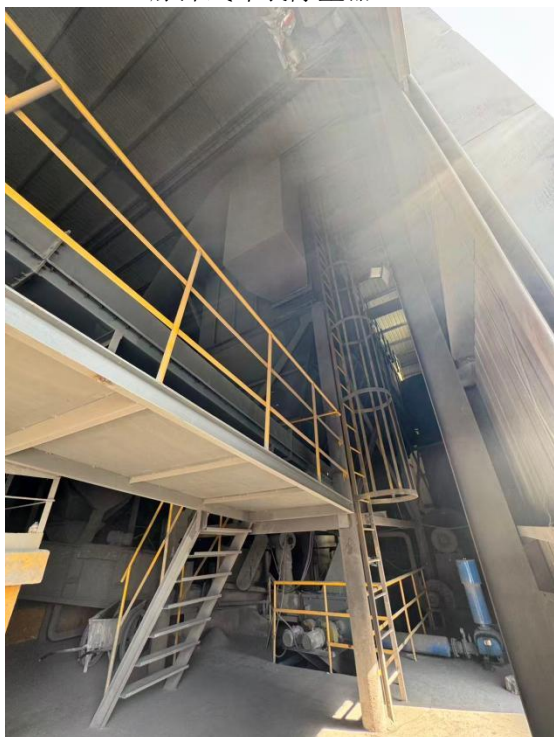
辅料球磨机和气力复合式混料机 废气处理设施 TA019
