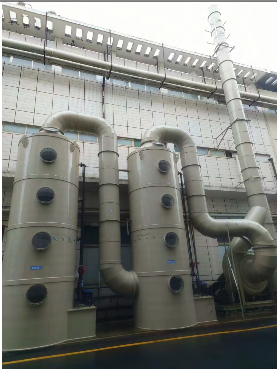
碱雾废气处理设施-酸喷淋+碱喷淋装置（DA011）
