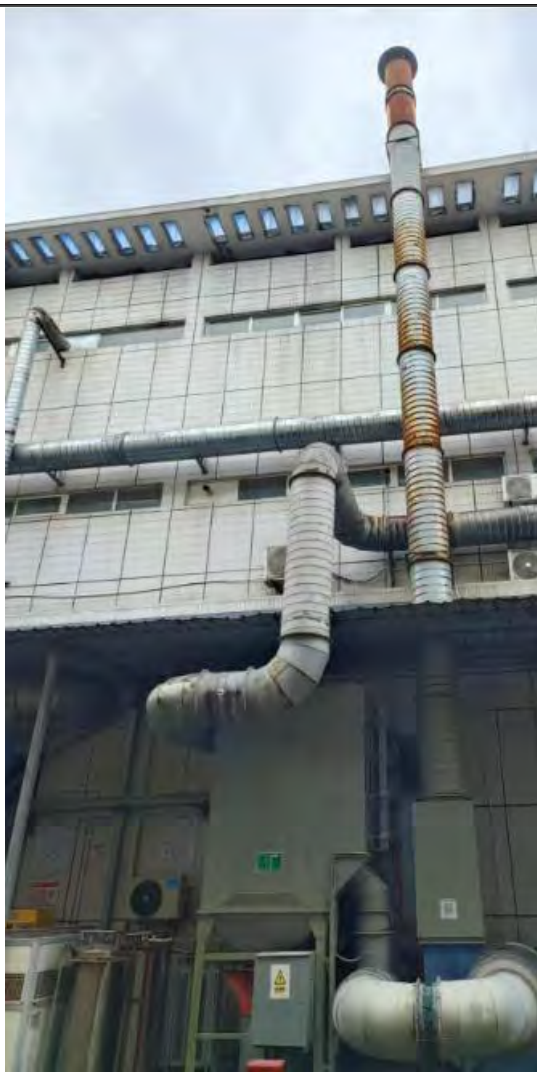
滤芯除尘装置（TA007）
