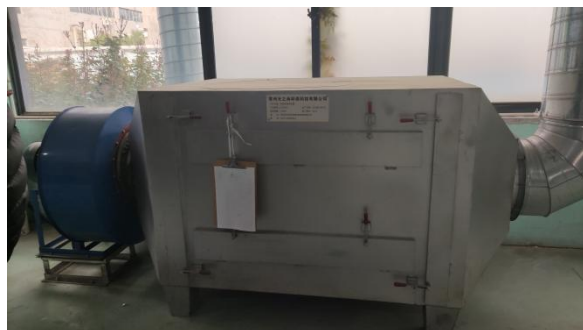
图3-5 干式过滤+活性炭吸附装置
