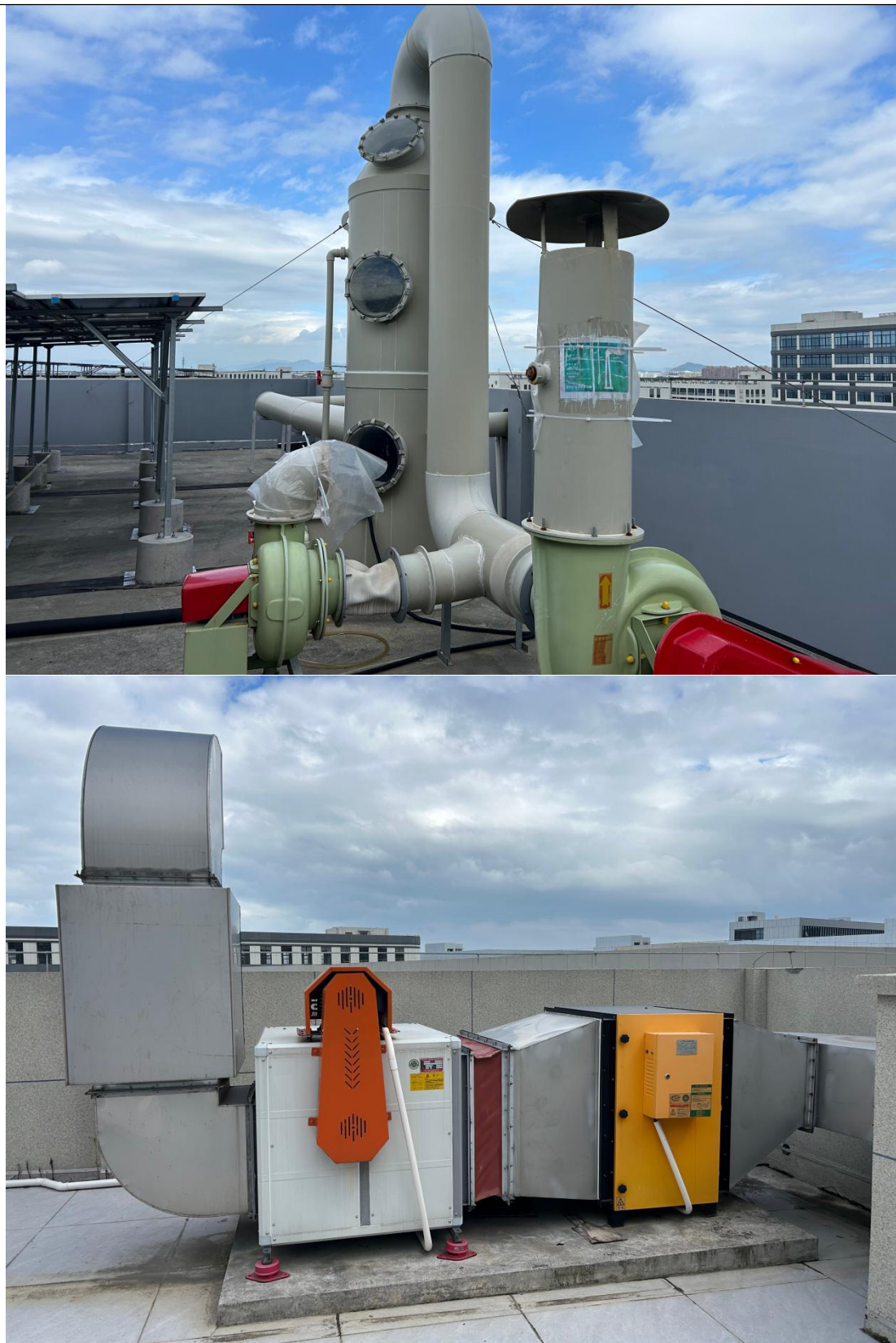
图 3-5 废气处理设施现场图
