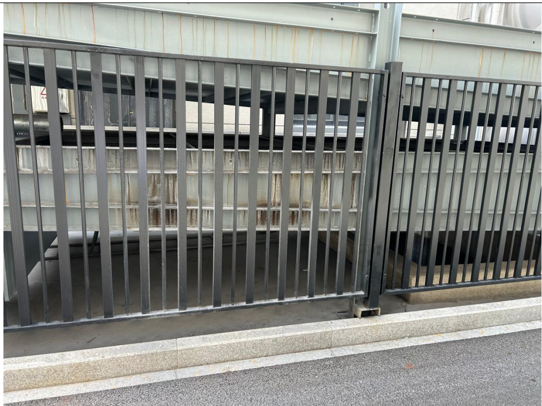
图 3-2 “二级沉淀+三级过滤”处理设施现场图
