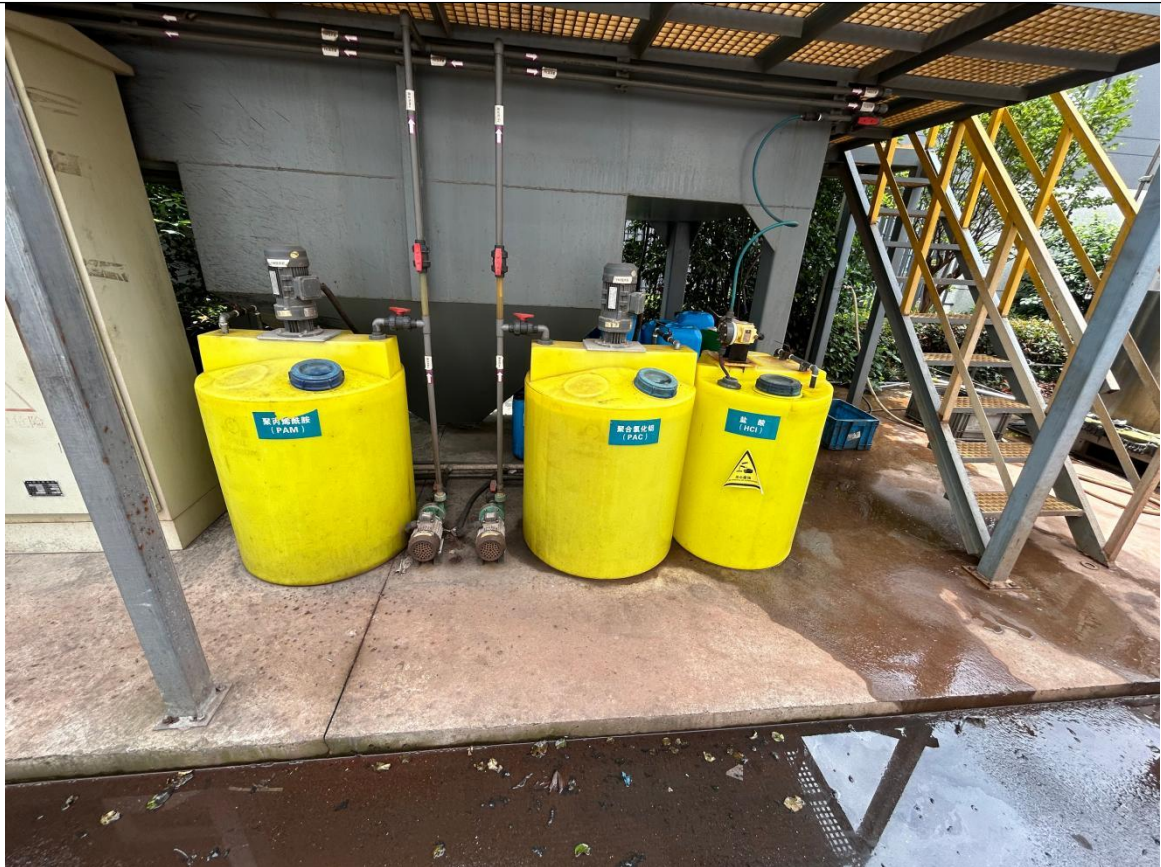
图 3-1 自建污水站现场图
