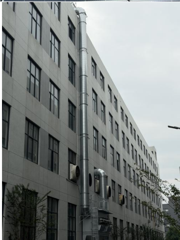
图 3-4 废气处理设施现场图
